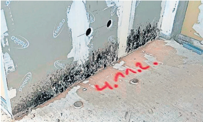
Schimmel an der Trockenbauwand: Laut Sachverständigen ist das im Gebäudebau gar nicht so selten. Foto: privat
