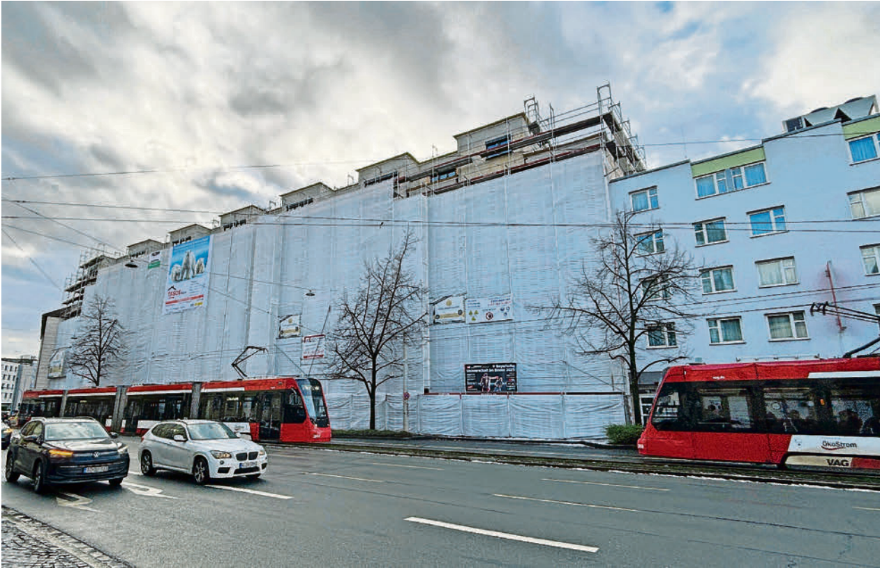
Im Dezember 2025 sollten die „City-Apartments“ in der Steinbühler Straße 4-6 in Nürnberg bezugsfertig sein. Daraus wurde nichts. Das Bild entstand im Januar 2026. Foto: Stefanie Banner
